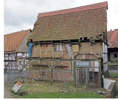
Leerstehendes Fachwerkgebäude in abbruchreifem Zustand in der Ortsmitte
